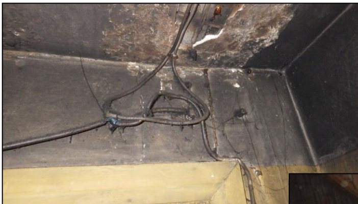
◀ <06> 3. att. Atsevišķās vietās elektroinstalācijas stāvoklis rada bažas
