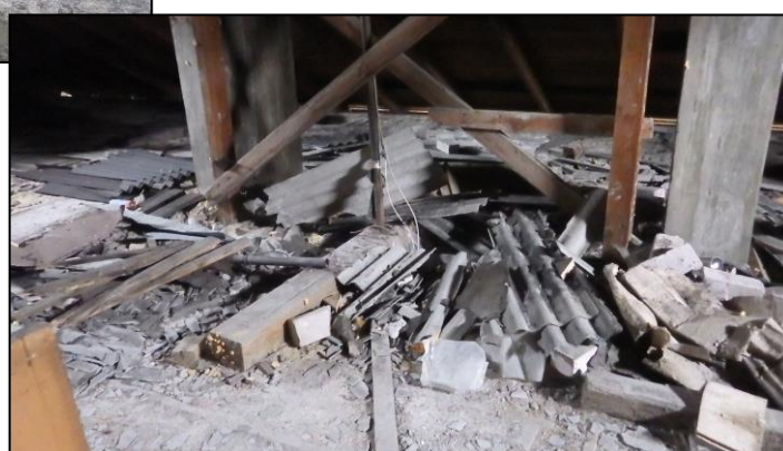
<09> 4. att. ▶ Bēniņos daudz azbestcements lokšņu atlūzu
