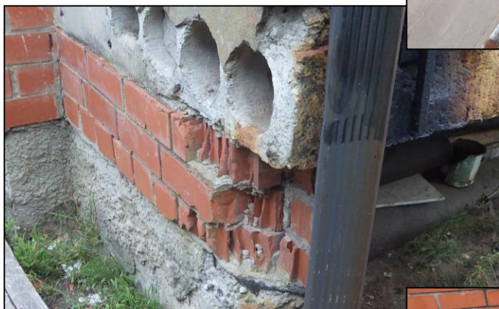
◀ <20> 3. att. Mūrējuma korozija
