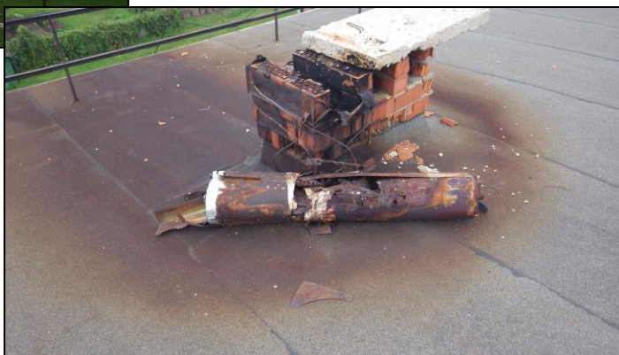
<07> 2. att. ▶ Daļai agrāko vēdkanālu, kas izmantoti kā dūmvadi, stāvoklis ir bīstams
