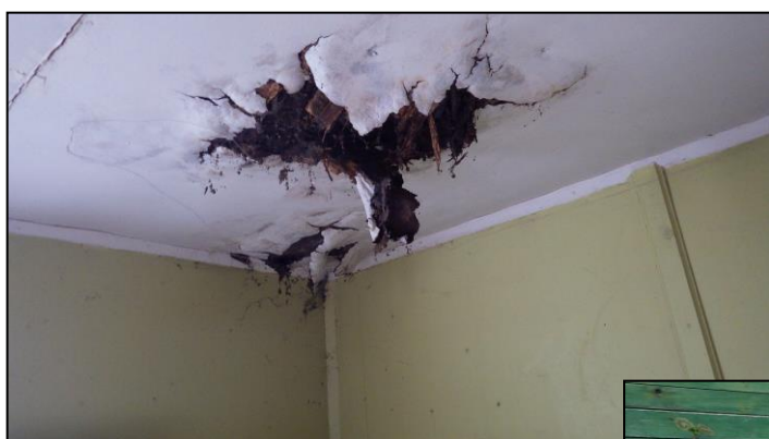
◀ <03> 3. att. Ilgstošas nokrišņu ūdens caurplūdes sekas: — bojāti iekšējās griesti
