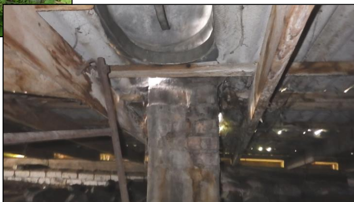
<02> 4. att. ▶ Jumta pārseguma stāvoklis kopumā nav apmierinošs
