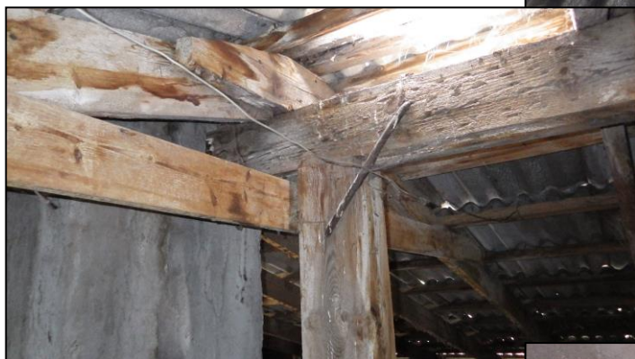
◀ <01> 3. att. Jumta kore nepilnīgi segta, ļaujot nokrišņu ūdenim viegli iekļūt bēniņos
