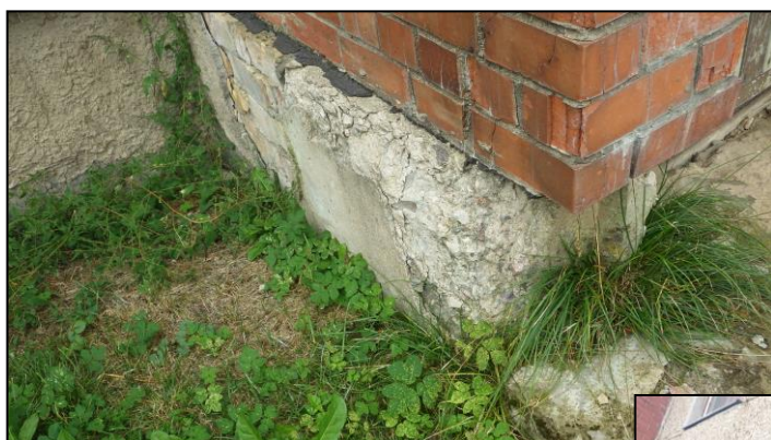
◀ <07> 3. att. Pamatu bloka betons sairst
