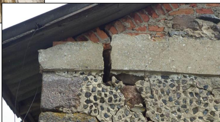
<11> 4. att. ▶ Mūra ārsienas deformācijas sekas: atšķelšanās
