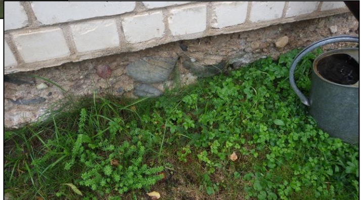
<04> 2. att. ▶ Lentveida pamati veidoti no ļoti vāja betona
