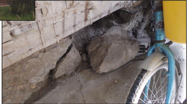
<06> 2. att. ▶ Kāpņu telpā šķērssienu pamatu līmenis nepilnvērtīgs
