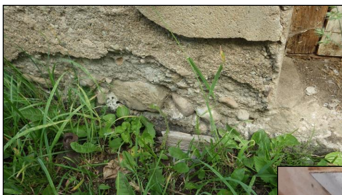
◀ <02> 3. att. Cokola līmenī pamatu betonējums nekvalitatīvs
