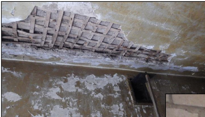
◀ <04> 3. att. Lokāls koka pārseguma nopietns bojājums
