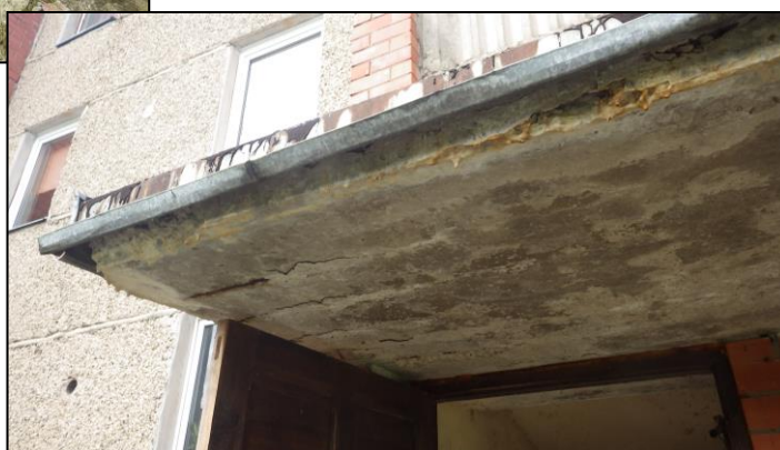
<07> 4. att. ▶ Nama ieejas bloka virsjumtiņš korodē
