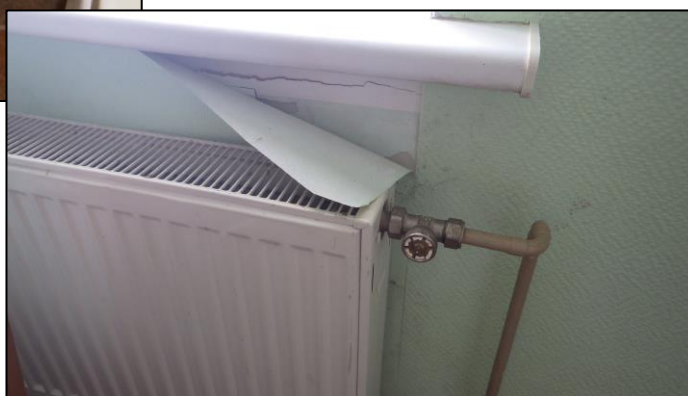
<18> 4. att. ▶ Apdares bojājums (iekštelpa)
