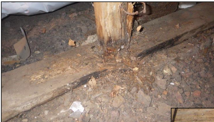
◀ <16> 3. att. Satrunējusi koka konstrukcija bēniņos
