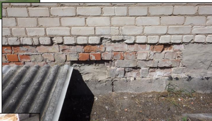
<01> 2. att. ▶ Cokola līmenī konstatēta mūra korozija
